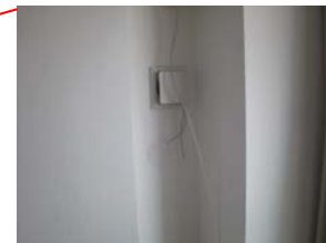
▲臭気浸入箇所
